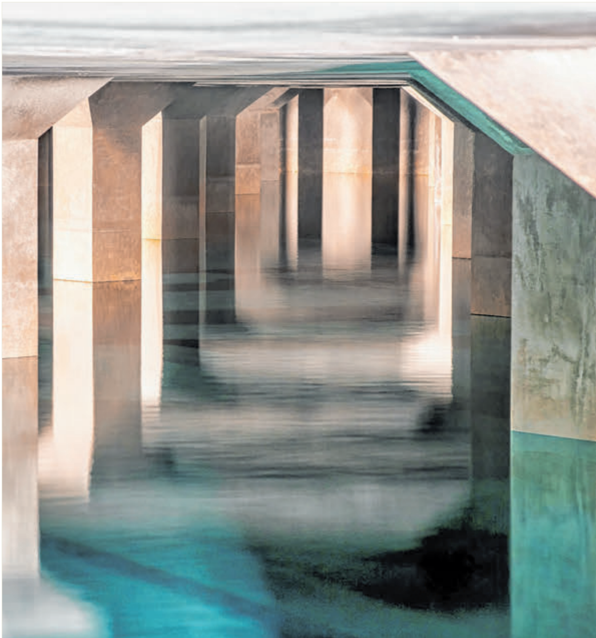
Trinkwasserbehälter der Innsbrucker Kommunalbetriebe in Mühlau: Von der Quelle bis zum Endverbraucher passiert das Wasser ein Netzwerk aus Leitungen und Knoten.
