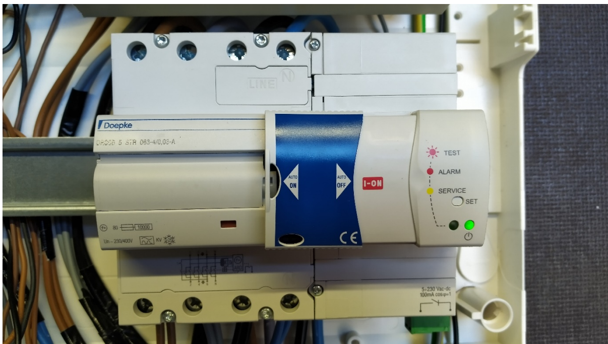
Abbildung 35: Der automatische FI-Schalter im Container IHE. Foto: Rainer Prinz, 29.07.2021.
