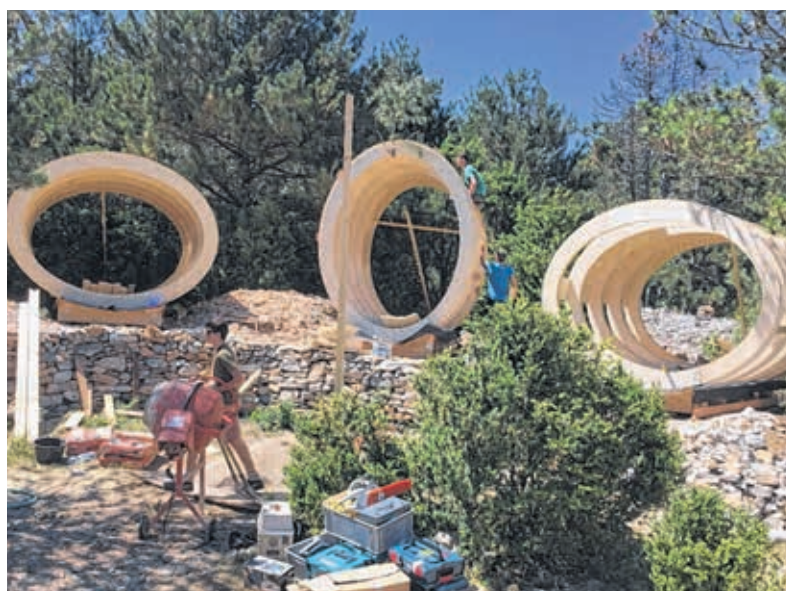
Oben: Aus unzähligen Einzelteilen wurden die Fässer gebaut. Die Teile wurden vorab mit Hilfe einer CNC-Fräse zugeschnitten. Mitte: Ein Kraftakt: Jede einzelne Ellipse musste genau in Position gehoben und verankert werden. Unten: Zwei liegende, eine stehende Ellipse: Allein die Drehung des Baukörpers schafft eine völlig neue Raumsituation.
