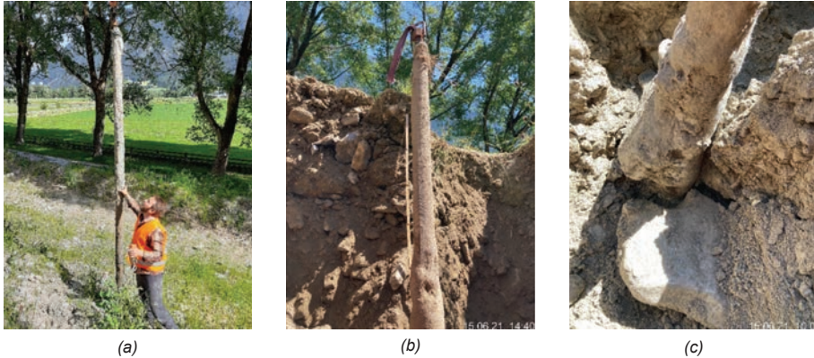
Bild 6, Ausbau der Anker, (a) kein Verbund mit dem Baugrund, (b) geringer Verbund mit dem Baugrund, (c) Durchbohren von Steinen im Baugrund
