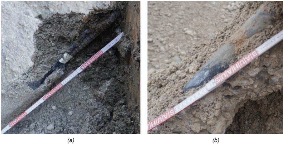
Abbildung 4: Stahltragglied am Übergangsbereich zum Betonfundament mit unzureichender Zementsteinüberdeckung (ohne Pfahlhalsverstärkung, links) sowie mit ausreichender Zementsteinüberdeckung durch eine Pfahlhalsverstärkung (rechts) (Fotos: Wimmer)
