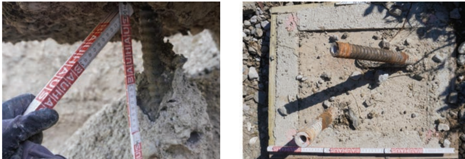
Bild 6, (a) freigelegtes Hilfsfundament mit beschädigtem Verpresskörper am Druckpfahl (b) Risse im Betonfundament
