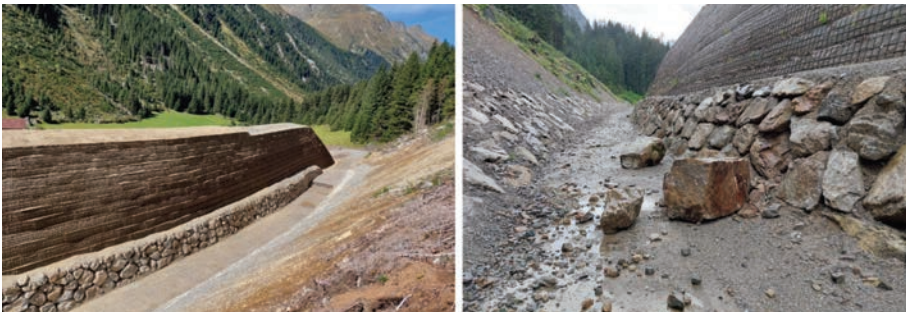
Bild 7, links: fertig gestellter Steinschlagschutzdamm (vor Begrünung) mit einer Höhe von 9,5 m, Fallboden, Wasserhaltung. Rechts: Erster Lastfall durch Steinschlag im Juli 2023
