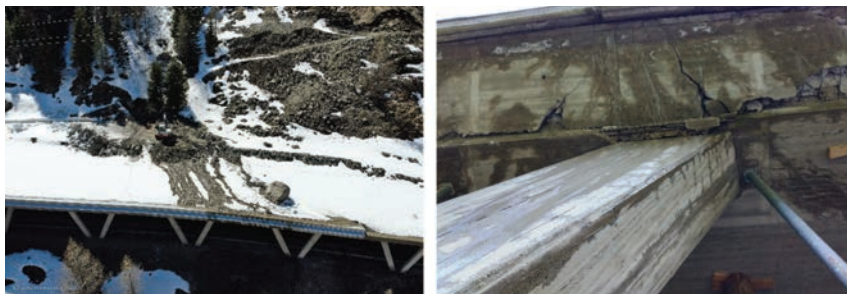
Bild 8, B 186 Ötztalstraße, Blocksturz Leckgalerie
