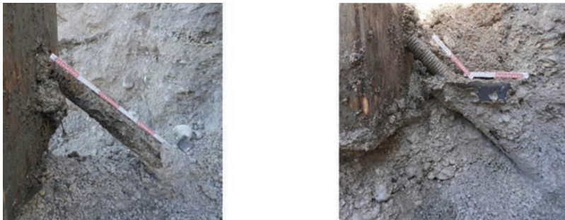
Bild 7, (a) Zuganker mit Streckmetallrohr nicht vollständig ausinjiziert (b) Zuganker mit doppeltem Korrosionsschutz
