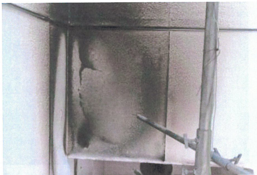
Bild 10: Detailaufnahme nach Versuchende – Risse im Putz
